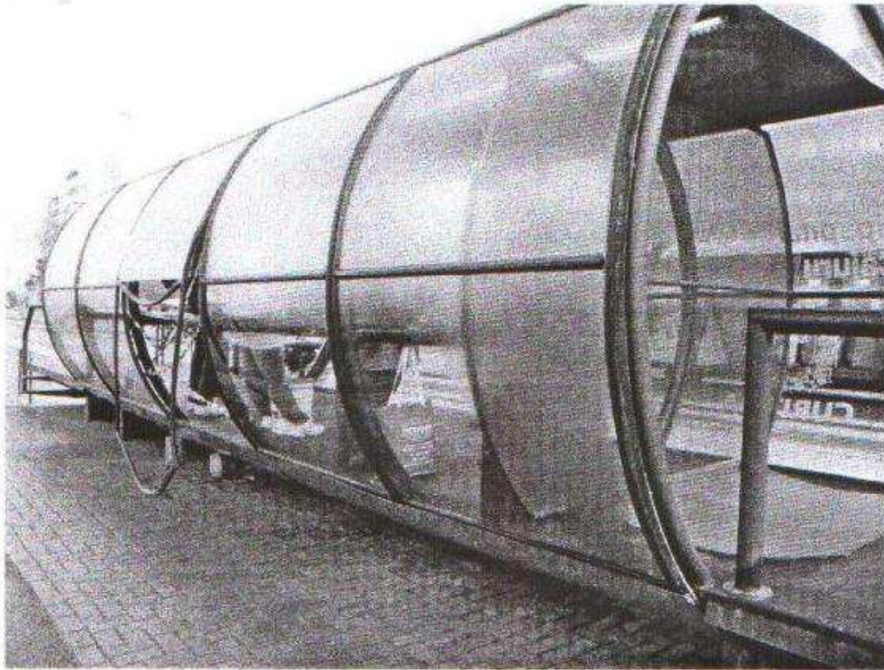
Foto 02 – Ausência de vidro na parede da estação tubo Hospital Cajuru , contribuindo para a entrada de ar frio no seu interior. Relato de que essa situação já durava mais de 5 dias.
